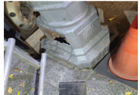
허가되지 않은 곳에서의 반·출입 및 인도(가로등)파손 사례
