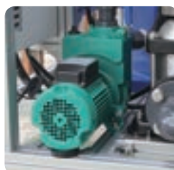
벤추리 전용 순환펌프(윌로)
