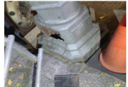
허가되지 않은 곳에서의 반·출입 및 인도(가로등)파손 사례
